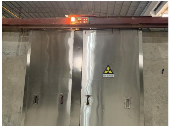
图6-4 机房防护门警示灯
